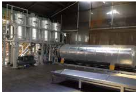
減圧・加圧薬剤含浸処理装置
